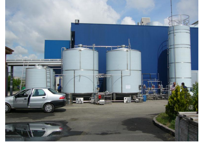
Pilot Biyogaz Tesisi
